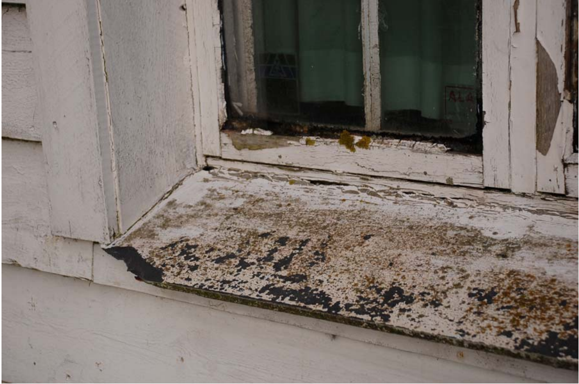
Råteskader på vindu. sørvegg
