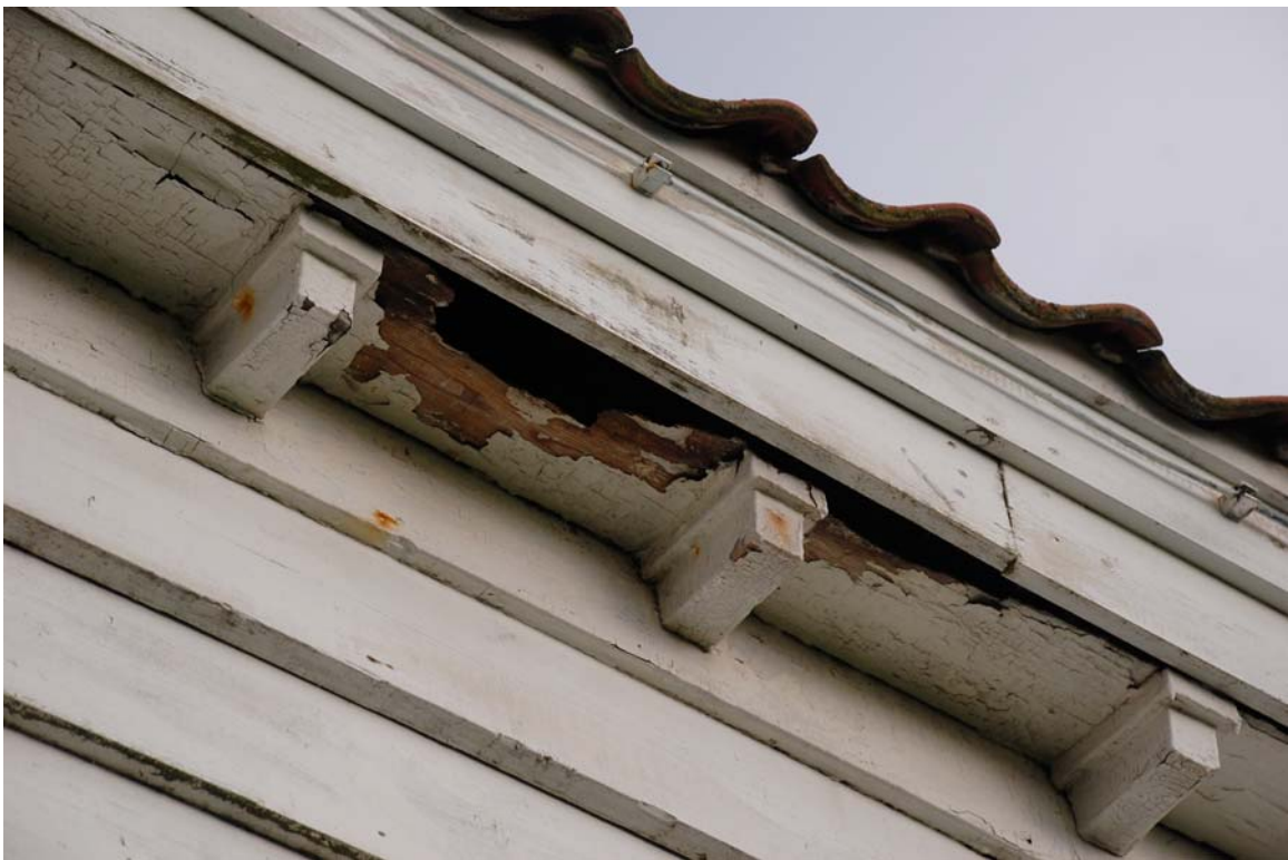
Råteskader i gesims. sørvegg
