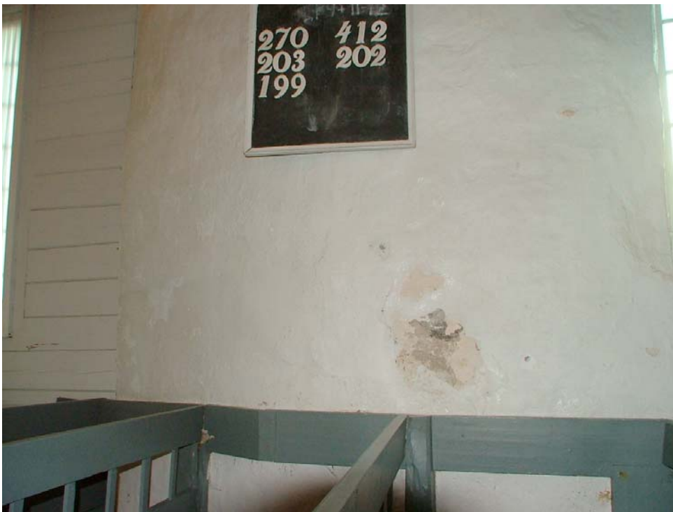
Fuktskader i murvegger i skipet.
