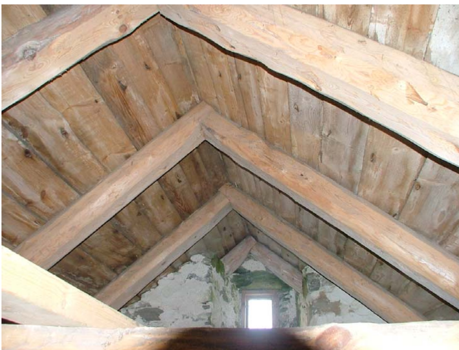
Sperr og sutak ved møne, ved vestgavl.
